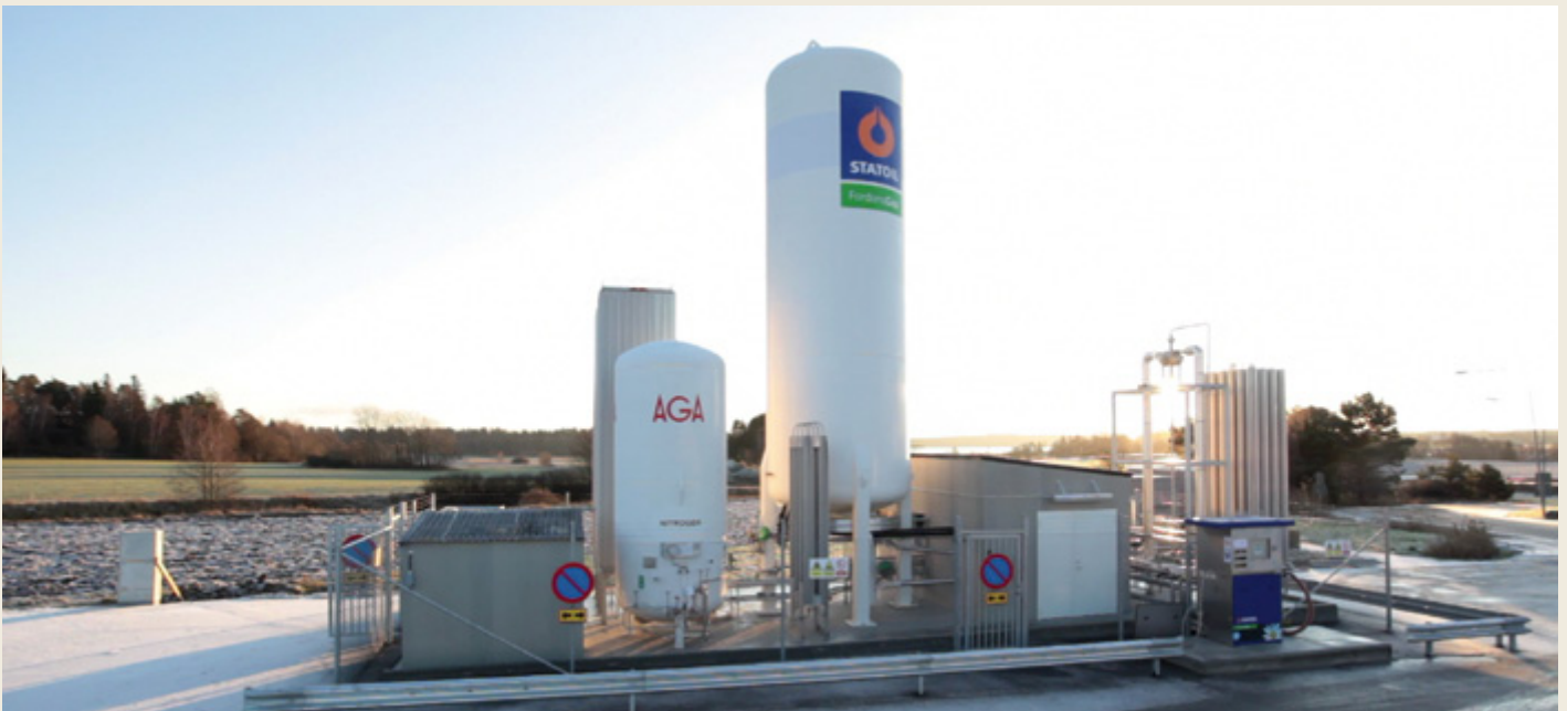
Den här tankstationen i Stockholm är utrustad med kombinerad LNG- och LCNG-teknik från AGA.
